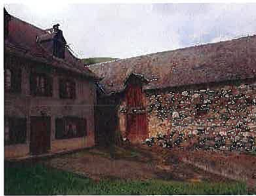
Toiture sans gouttière
