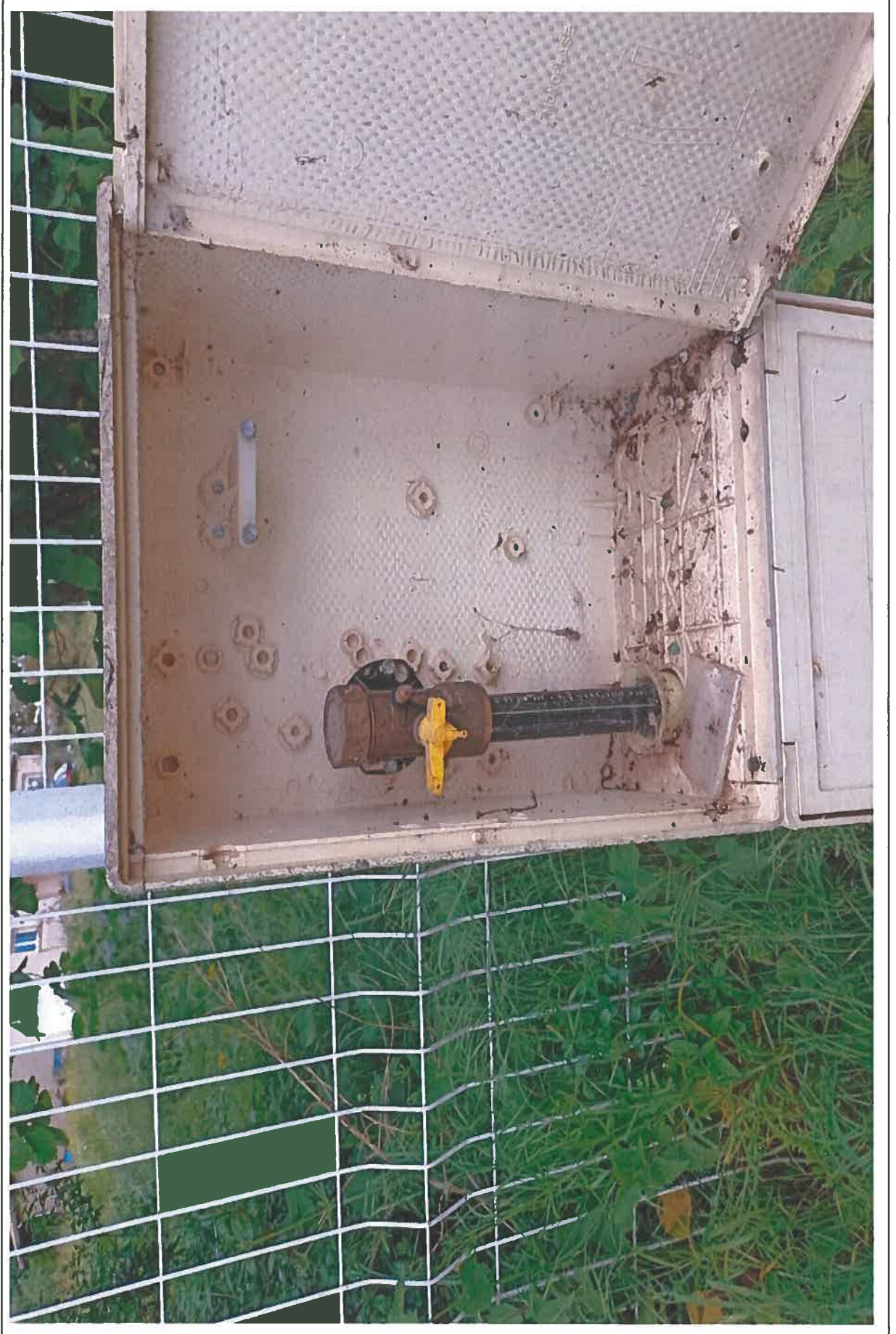
PHOTO Coffret ouvert (Suppression)
